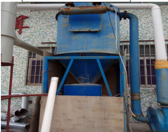
图 23FQ-144135C2 处理设施
